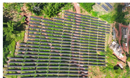
云南易门小禹石沙药光互补项目
